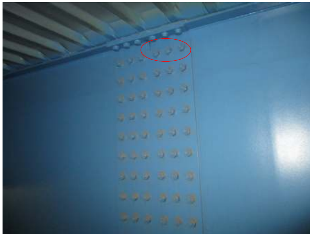
위 치 S2 G2 강거더 현 황 볼트탈락
