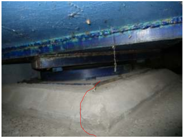
위 치 교량 받침(A2) 현 황 받침 Con'C 균열
