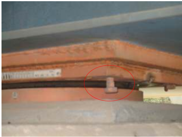
위 치 교량 받침 장치(P1) 현 황 받침 볼트 체결불량
